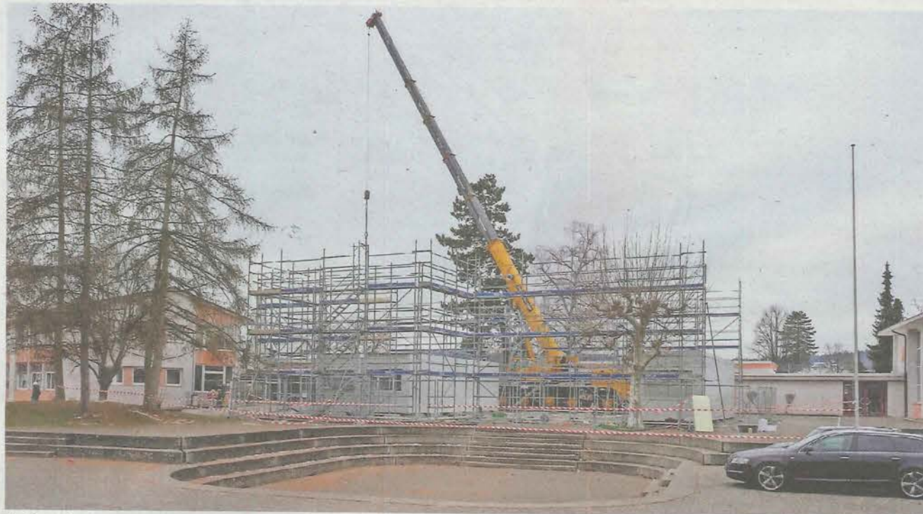
Aufbau der insgesamt 16 Container-Schulzimmer auf dem Schulareal Erlenweg in Oberentfelden. Ein Teil des Pausenplatzes fällt der provisorischen Lösung zum Opfer.
